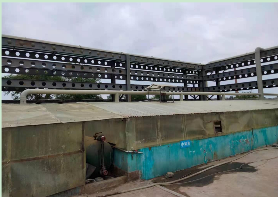
图 2.4.10 厂内污水处理站
